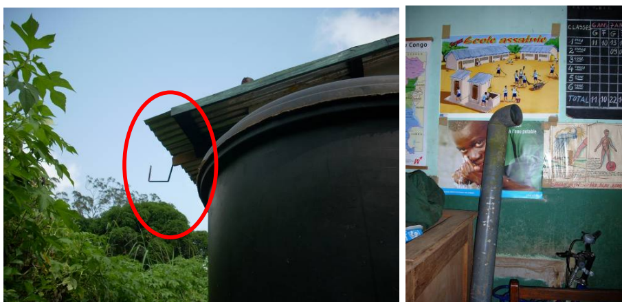
Illustration 16 : À l'EP 2 Noki, une gouttière et un raccord en PVC ont déjà été volés, les autres ont donc été retirés et sont gardés dans le bureau du directeur
