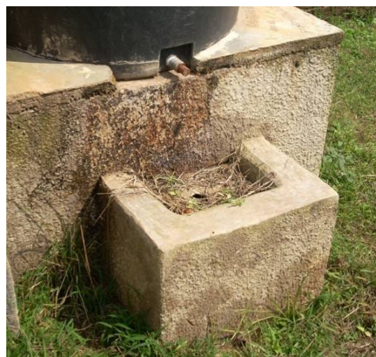
Illustration 7 : Un point de lavage des mains délaissé en l'absence d'eau
