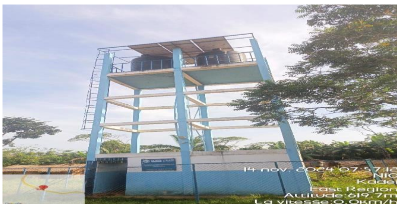
Image 6.7: Point d'approvisionnement photovoltaïque en eau potable, Commune de Kentzou, Village Mbouye
