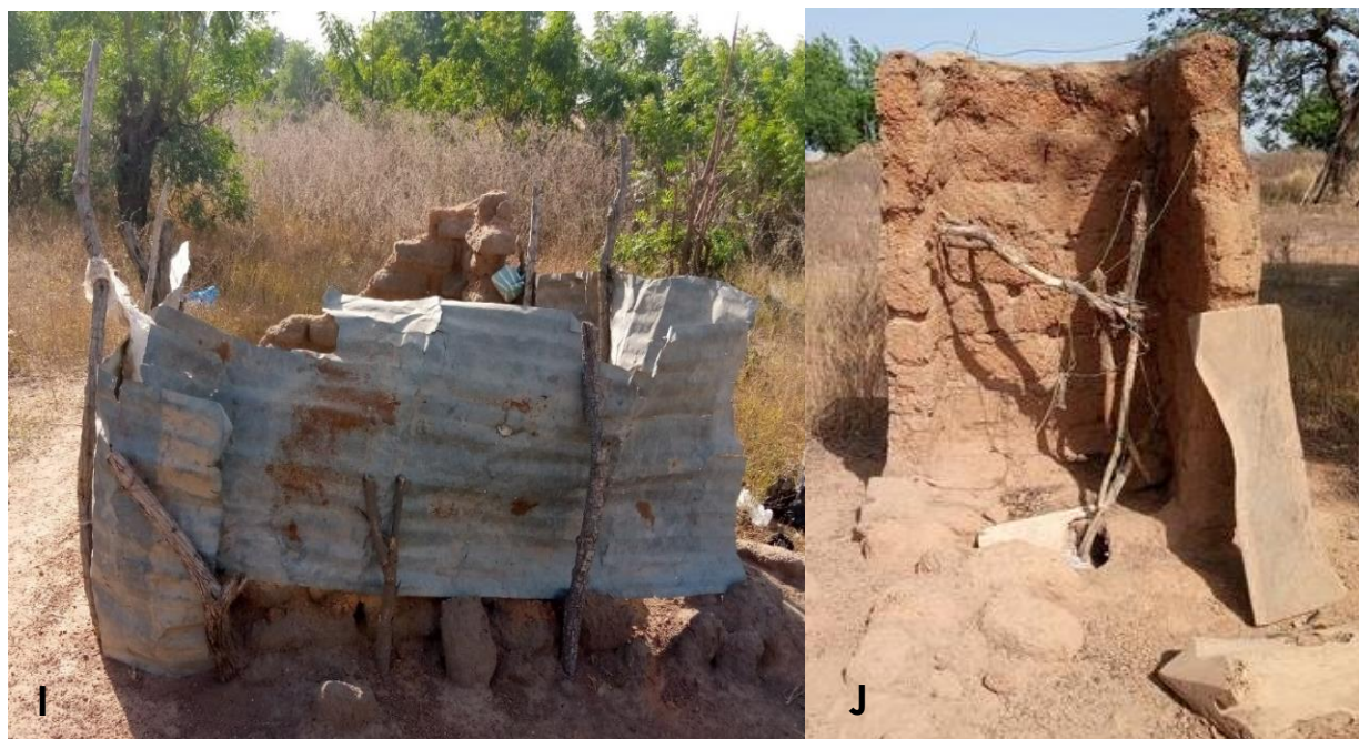
Illustration 5 : Des latrines familiales sommairement construites endommagées par les intempéries au Burkina Faso (I) et au Togo (J)
