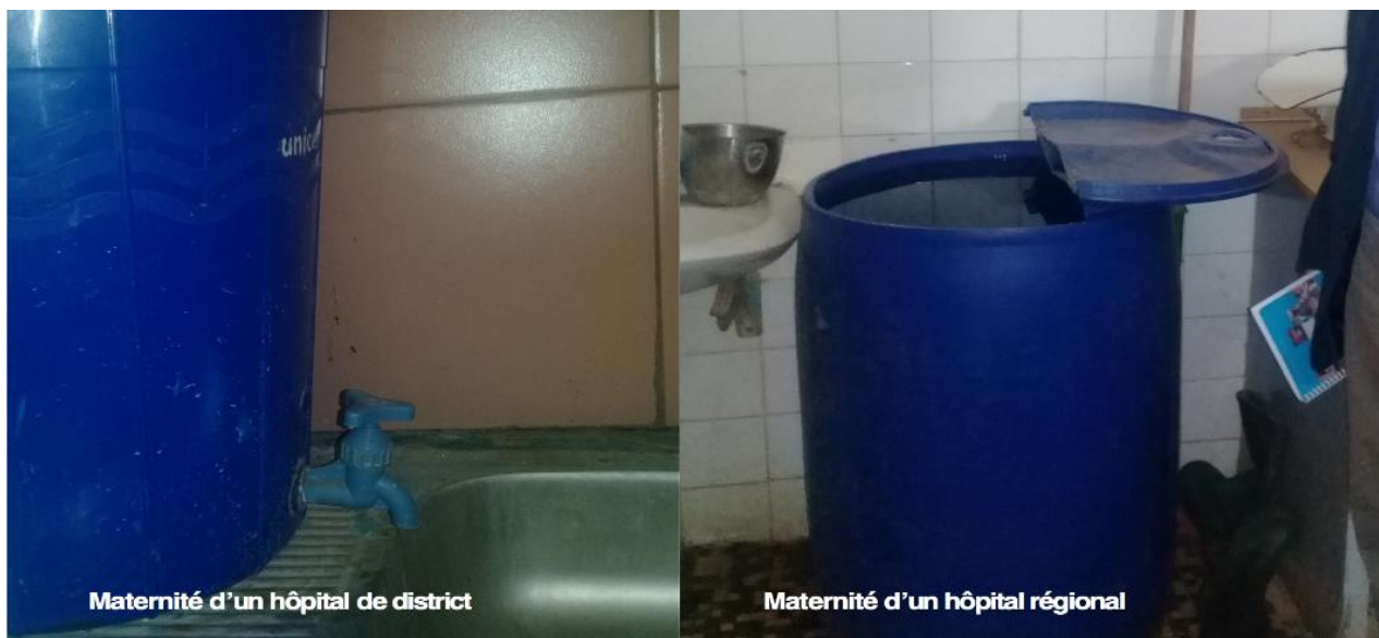
Figure 8: Dispositif d'approvisionnement en eau mis en place dans deux formations sanitaires
